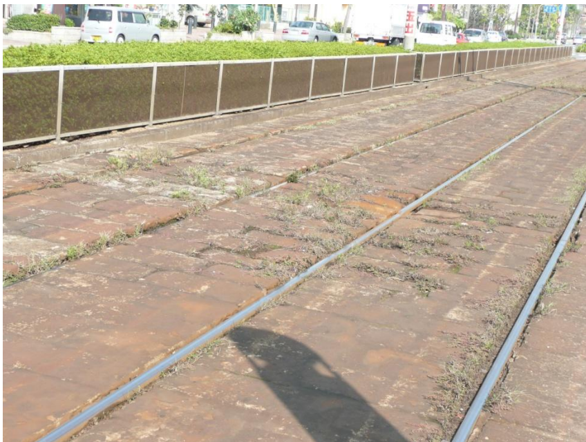
劣化した軌道（大小路近辺）
